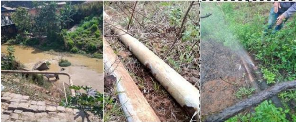
Figura 2 - Patologias identificadas na Adutora 3
