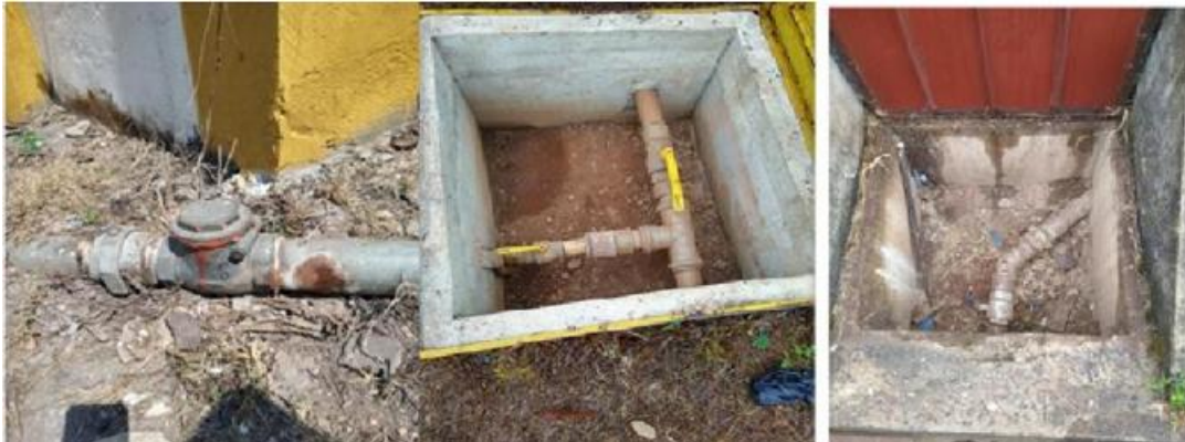
Figura 3 - Dispositivos operacionais da Adutora 3.
