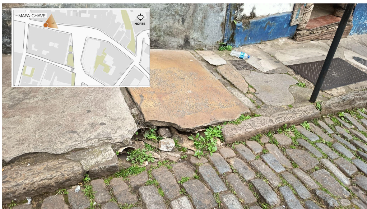
Figura 22 - Passeio irregular na Rua Cláudio Manoel.
