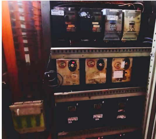
Figura 4 – Quadro de energia com os inversores. Fonte: Autor
