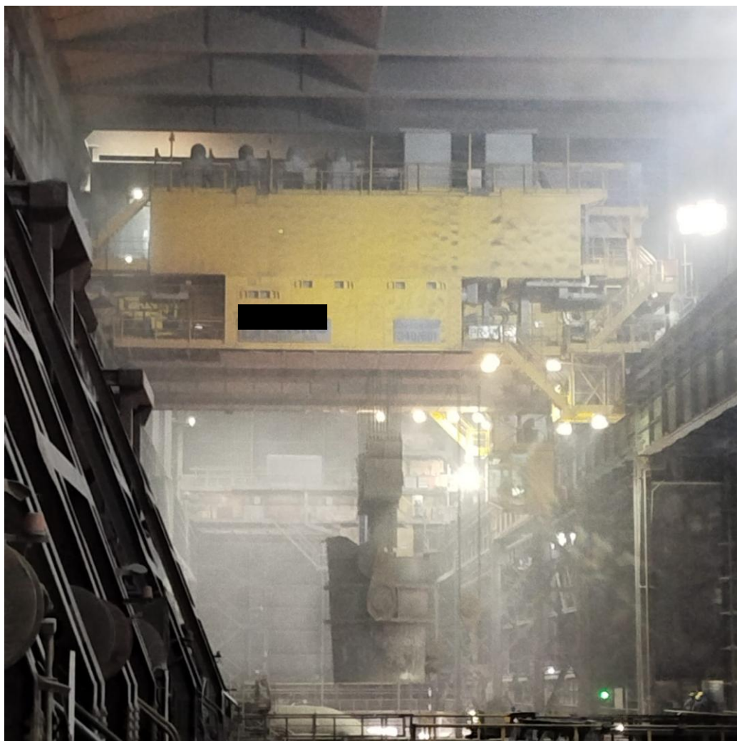
Figura 3: Vista geral da ponte rolante analisada.
