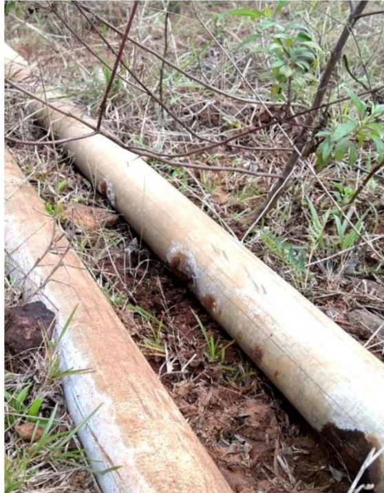
Figura 11 - Tubulação de recalque de corrosões acentuadas.
