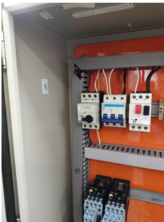
Figura 24 – Validação do protótipo em painel elétrico
