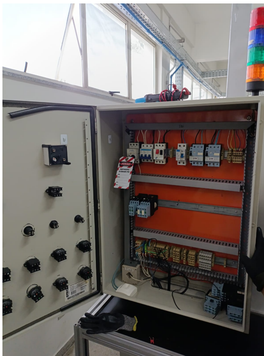
Figura 26 – Bloqueio do painel com cadeado e etiqueta
