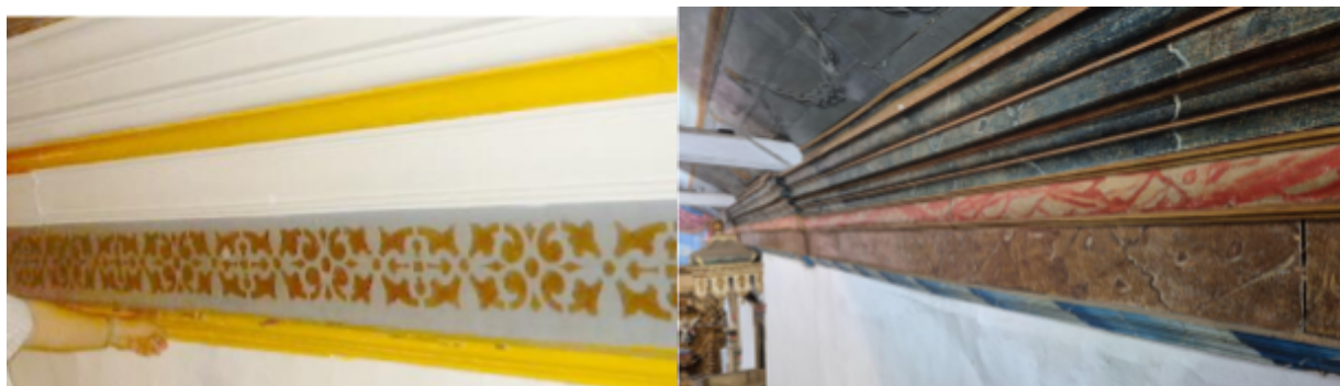
Figura 87: Em sequência, Cimalha do forro da Nave da Igreja Matriz de Nossa Senhora da Boa Viagem (Itabirito/MG), antes da execução das reformas iniciadas em 2003, e seu atual estado. Fontes: CECCONELLO, et al; Igreja de Nossa Senhora da Boa Viagem: dossiê de restauro. Itabirito: Paróquia de Nossa Senhora da Boa Viagem, 2005. Arquivo Pessoal; 02 de Maio de 2025.
