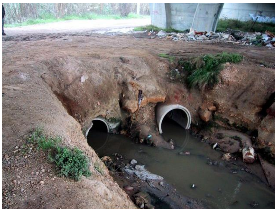
Figura 1 - Esgoto despejado no corpo receptor.
