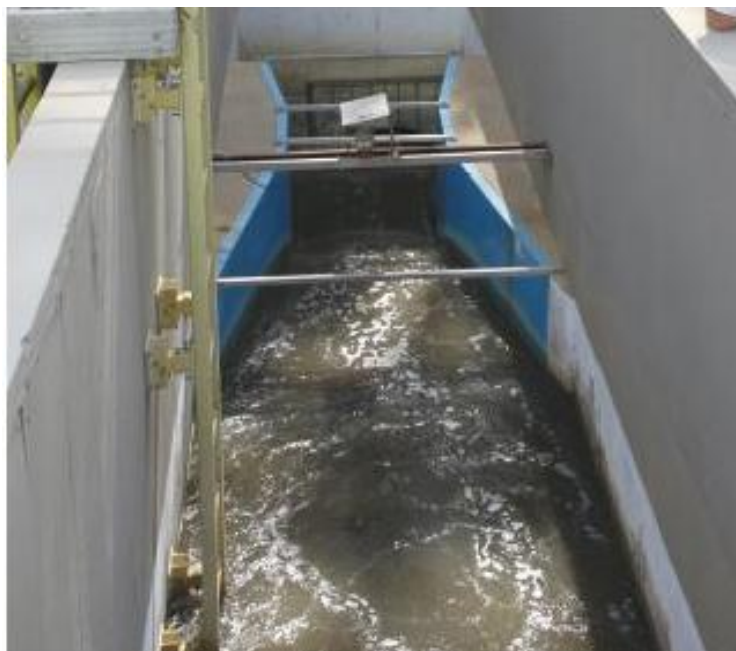
Figura 12 - Calha Parshall da etapa preliminar
