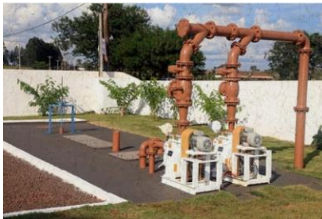
Figura 5 - Vista de uma estação elevatória.
