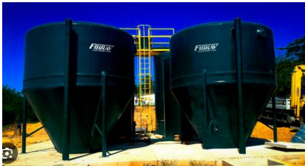
Figura 13 - Tanques de decantação
