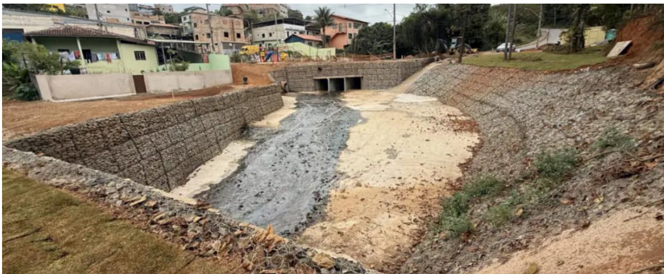
Figura 22 – Bacia de retenção e amortecimento do Córrego do Barro Preto, Mariana – MG.
