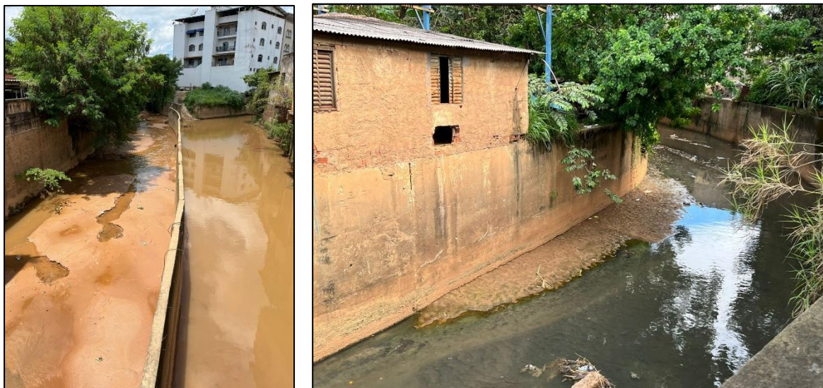
Figura 30 – Trechos assoreados ao longo do canal
