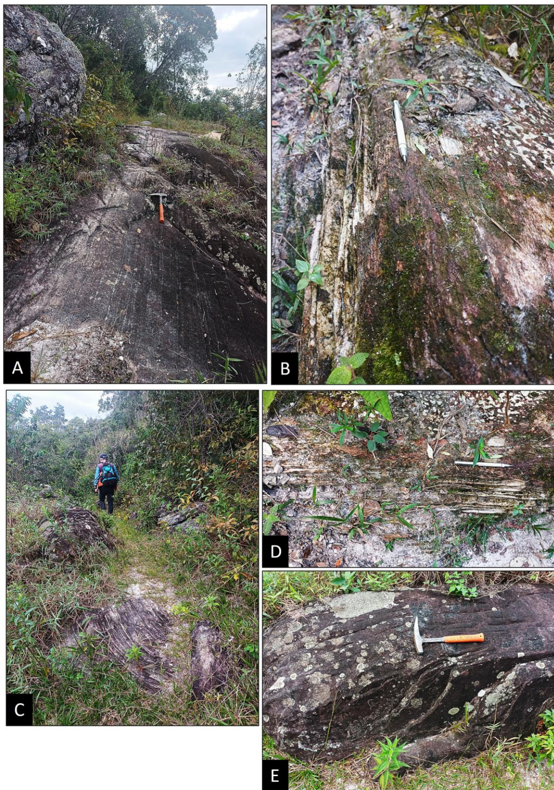
Figura 29- Estação 13: Conjunto de fraturas subverticais de orientação N-S identificados nas rochas quartzíticas do Supergrupo Estrada Real, na região de Cocais
