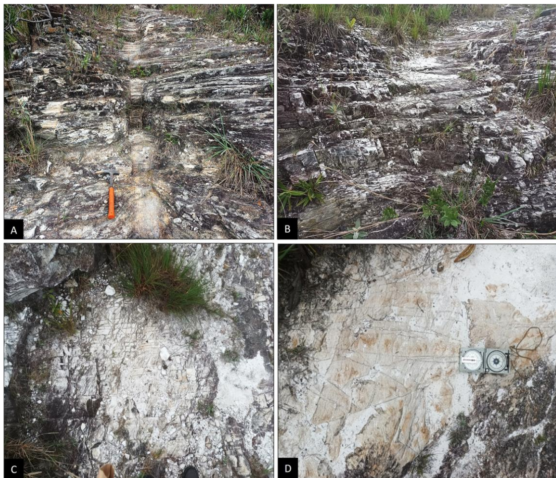
Figura 28 – Estação 11 e 12: A), B), C) e D) Alta densidade de fraturas subverticais de direção E-W nos quartzitos do Supergrupo Espinhaço.
