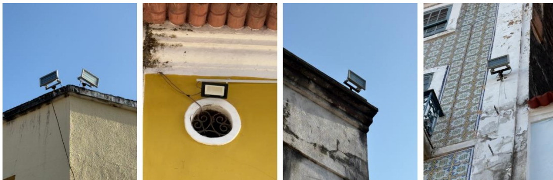
Figura 66 - Projetores existentes na rua Portugal
