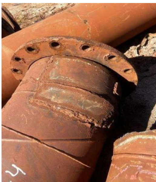
Figura 25 - Falha da estrutura metálica por desgaste Fonte: Pesquisa direta (2025)
