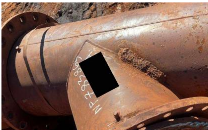
Figura 26 - Falha da estrutura metálica por trincas Fonte: Pesquisa direta (2025)
