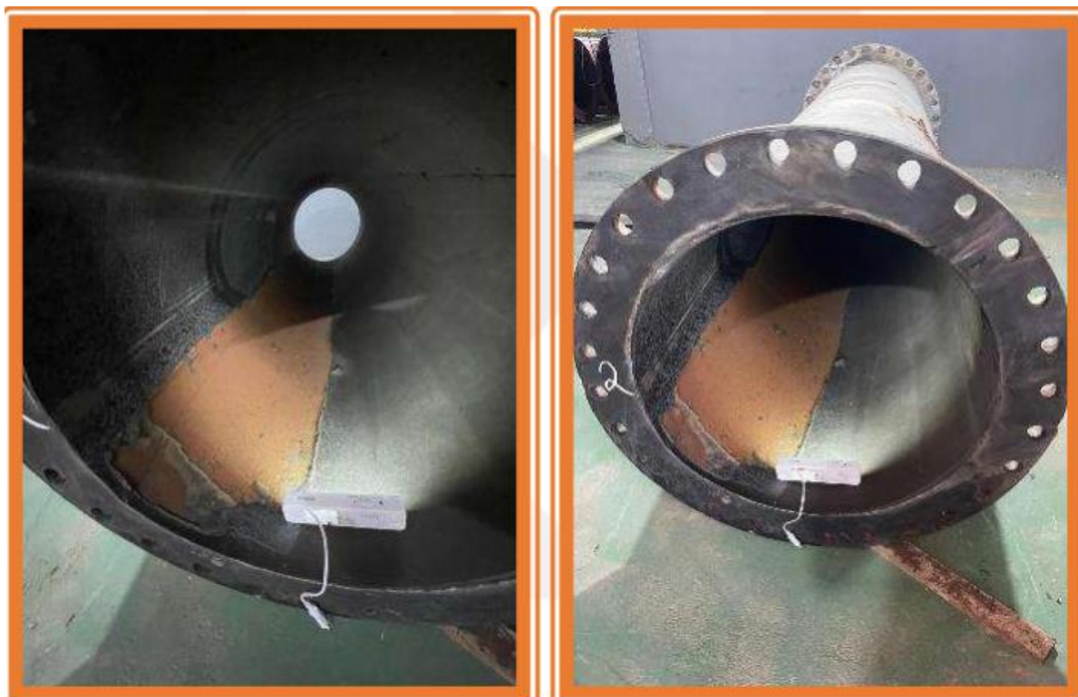
Figura 22 - Falha de Revestimento Fonte: Pesquisa direta (2025)
