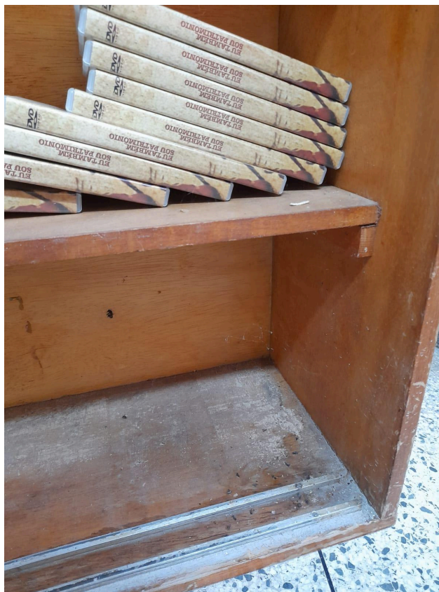
Figura 55- Manchas de umidade e sujidades no mobiliário 4.
