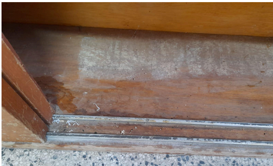
Figura 54- Manchas de umidade e sujidades no mobiliário 4.
