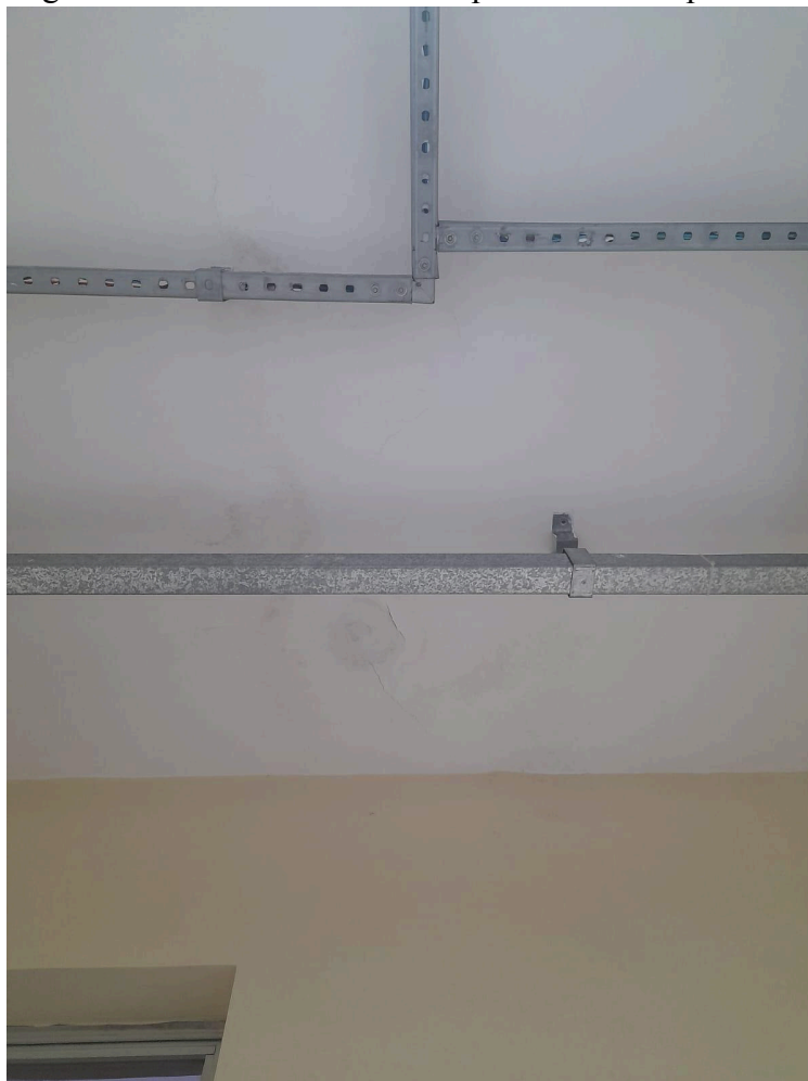
Figura 63- Manchas de umidade provavelmente por infiltração.
