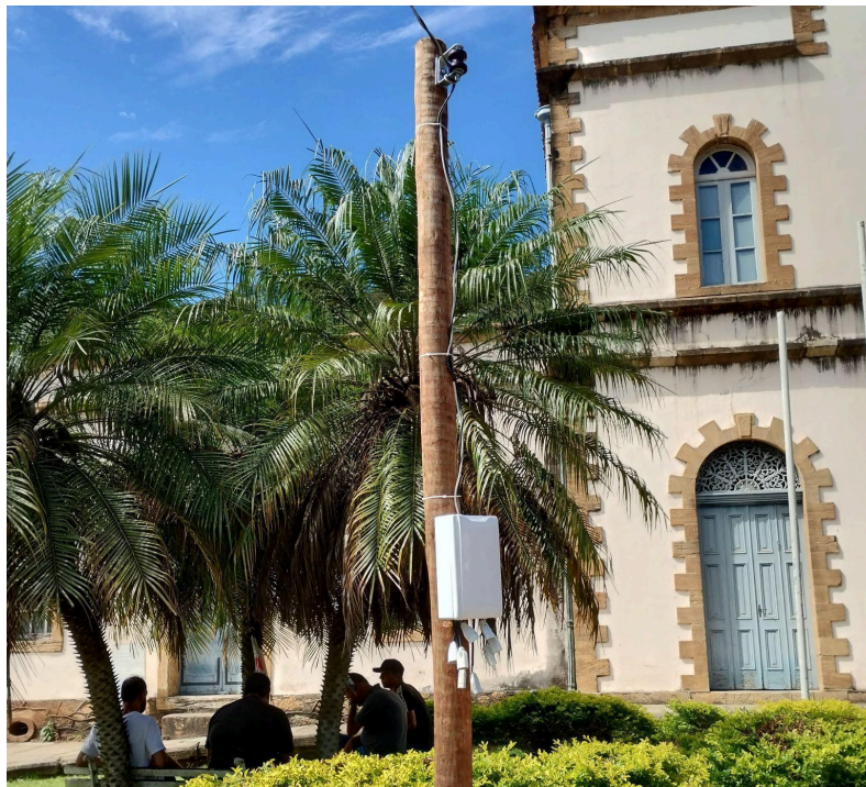
Figura 26: Quadro de luz que fornece energia para a feira noturna da Praça da Estação. (Fonte: acervo pessoal da autora)
