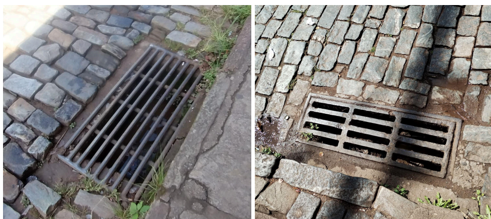
Figura 19: Bocas de lobo utilizadas na Rua dos Inconfidentes. ( Fonte: acervo pessoal da autora )
