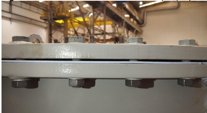
Figura 7 - Vista lateral mostrando a deformação (empeno)
