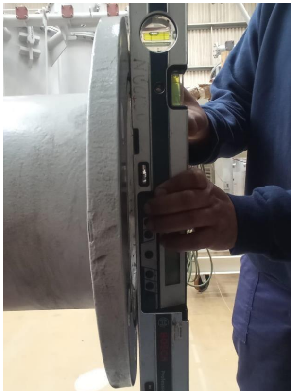
Figura 12 - Defeitos de montagem: flange empenado
