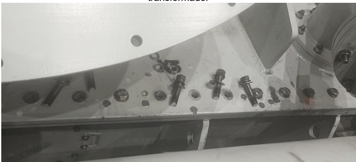
Figura 9 - Vista superior mostrando a deformação (empeno) em tampa de transformador
