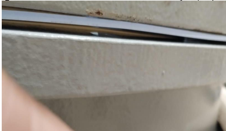
Figura 6 - Vista lateral mostrando a deformação (empeno)
