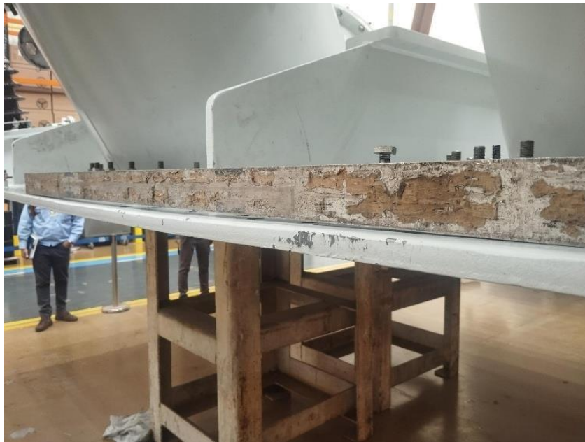
Figura 10 - Vista lateral mostrando a deformação (empeno) em tampa de transformador
