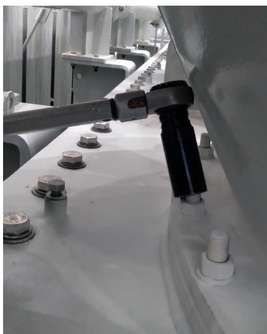
Figura 13 - Defeitos de montagem: angulação errada do caneco
