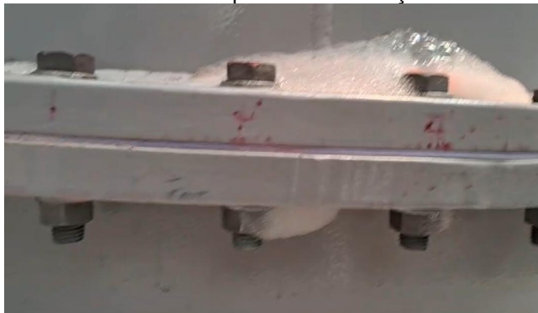
Figura 5 - Vazamento no flange da tampa observado no teste de vácuo: detalhe do ponto de exsudação
