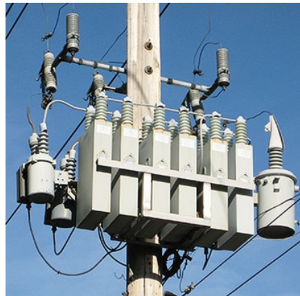
Figura 6 – Banco de capacitor chaveado
