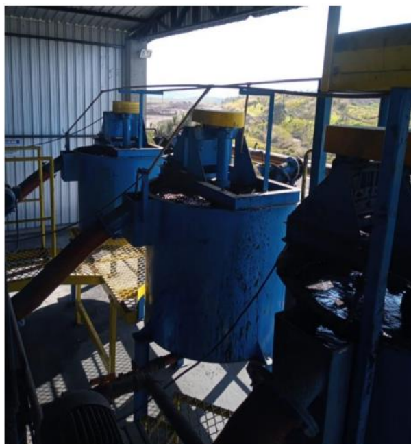
Figura 5: Tanques condicionadores e torneiras de saída de reagentes
