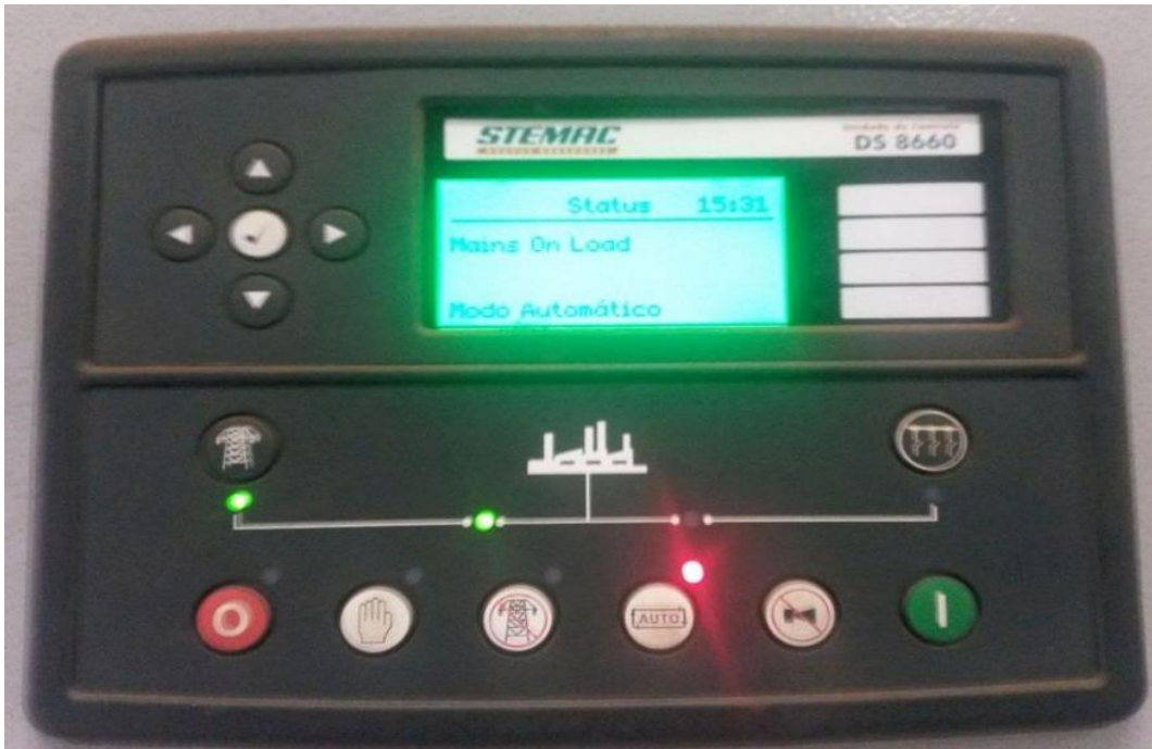
Figura 5.5: Módulo de controle DSE8660 em funcionamento
