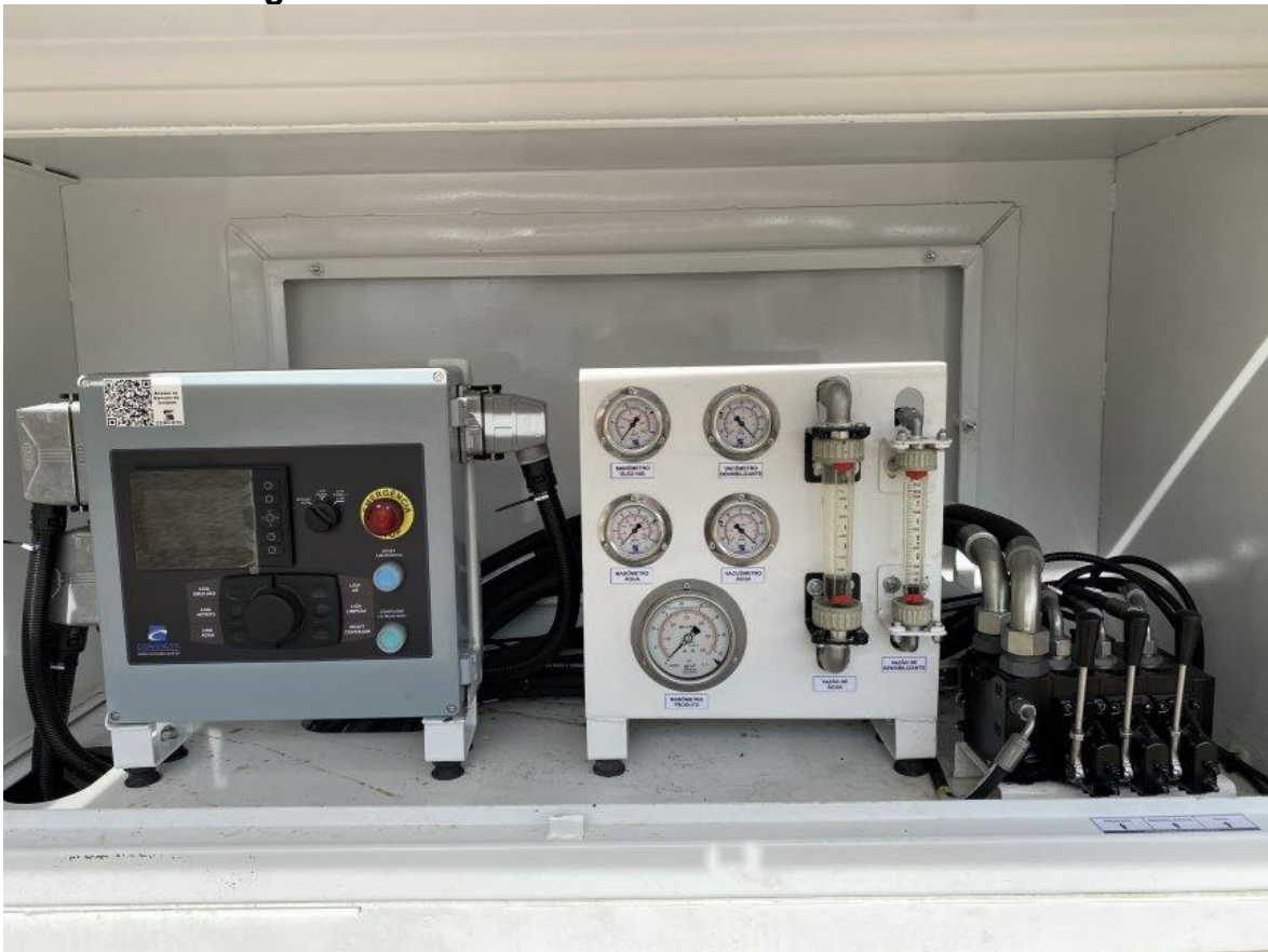
Figura 2 - Painel de controle do caminhão fábrica
