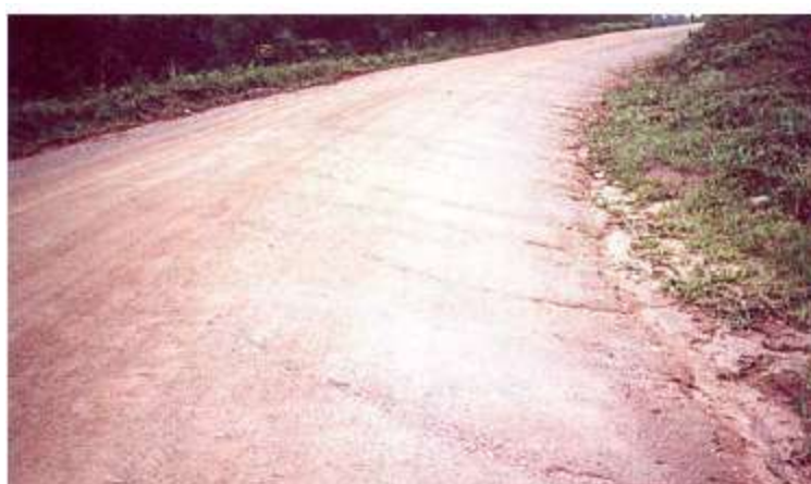
Figura 12 - Corrugações na pista devido a ausência de manutenção
