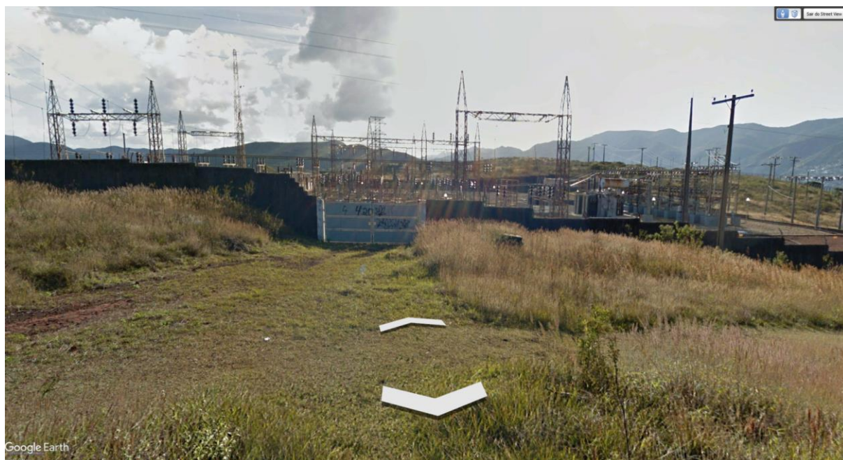
Figura 28 - Imagem da subestação de campus Morro do Cruzeiro
