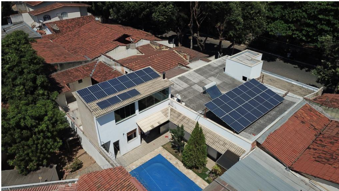
Figura 15 – Módulos fotovoltaicos instalados.
