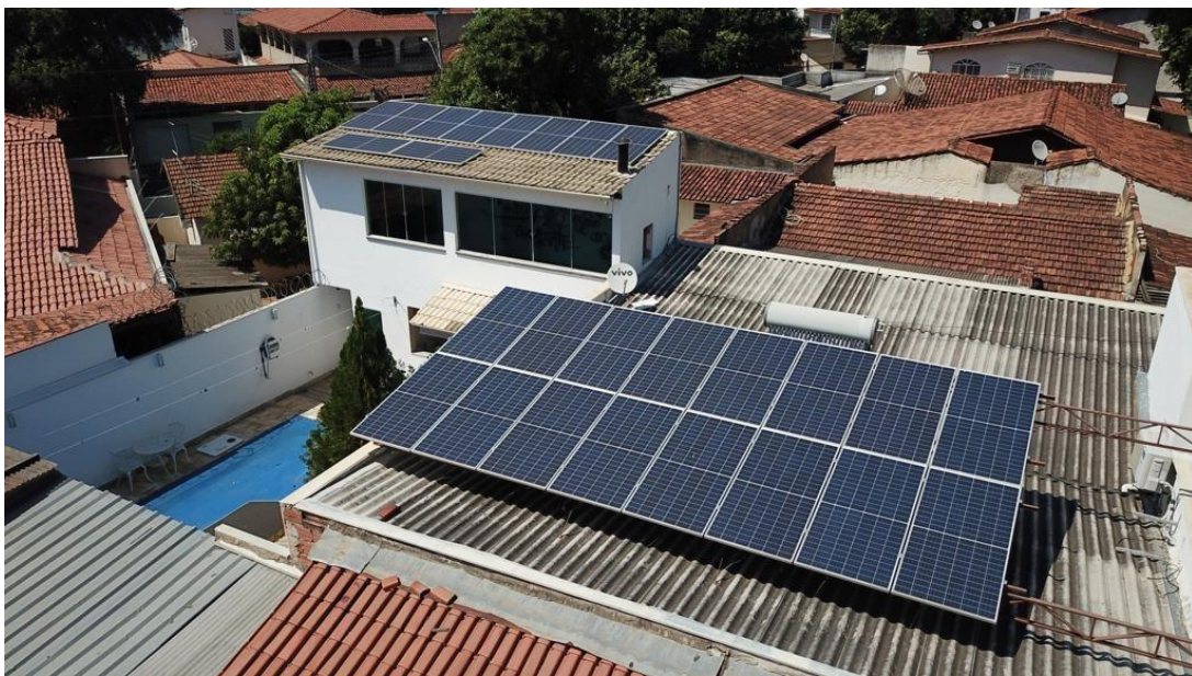
Figura 14 – Módulos fotovoltaicos instalados.
