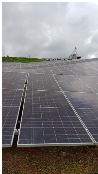
(a) Placas solares
