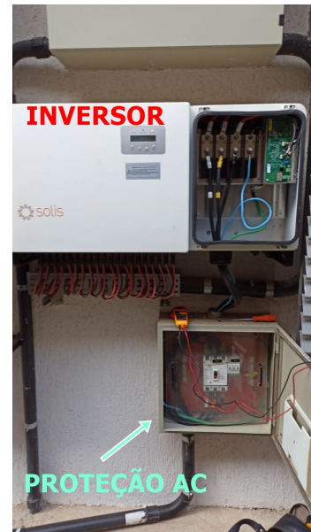
(c) Inversor fotovoltaico
