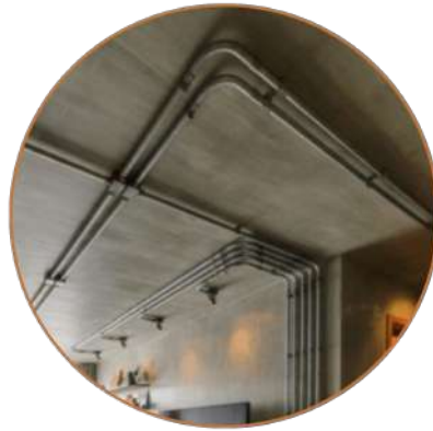
Figura 69 - Imagem referência de instalações elétricas aparentes.
