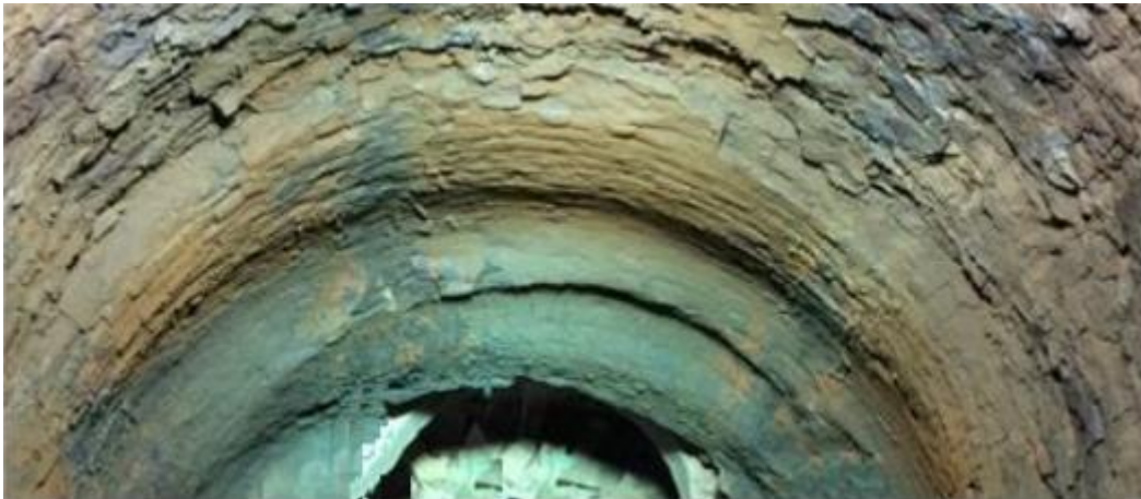
Figura 3. 9. Perfil de desgaste do vaso de um Desgaseificador RH
