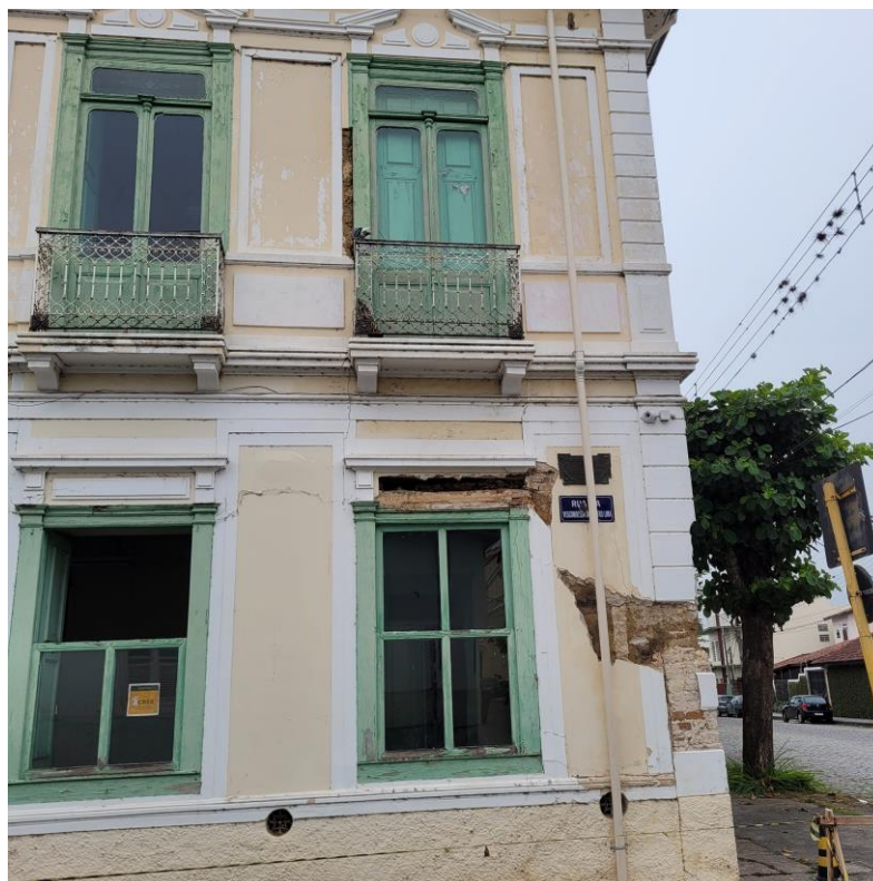
Figura 21 – Estado do Sobrado do Conde Moreira Lima em 2022 – Imagem 01
