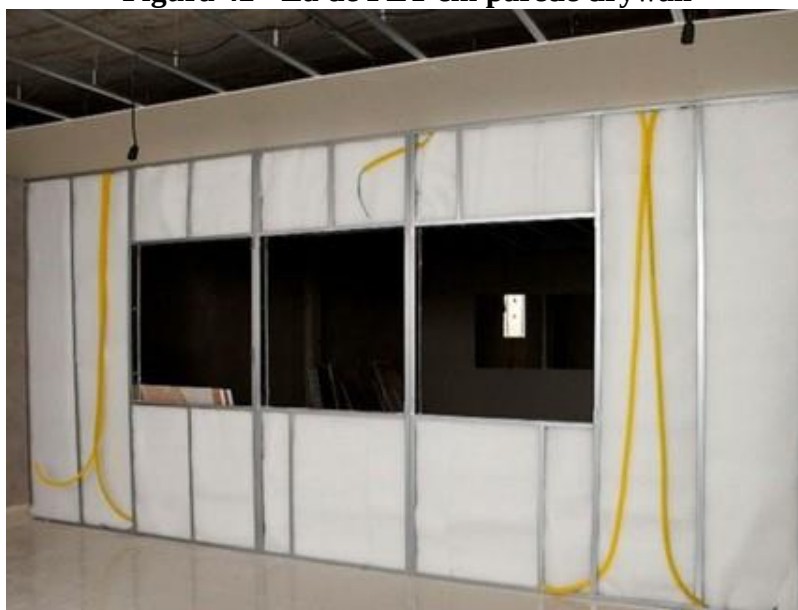
Figura 42 - Lã de PET em parede drywall
