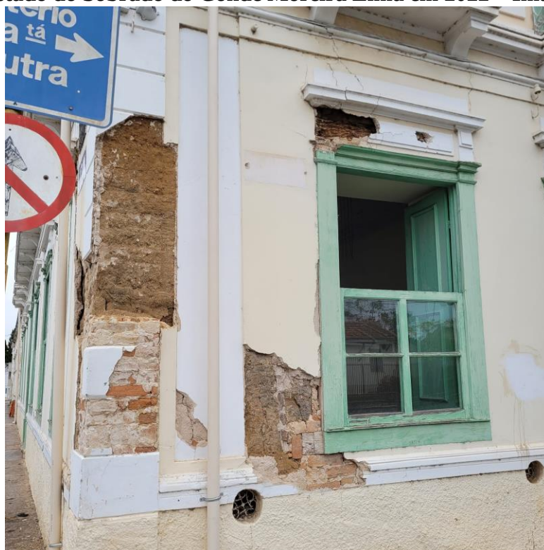
Figura 22 - Estado do Sobrado do Conde Moreira Lima em 2022 – Imagem 02
