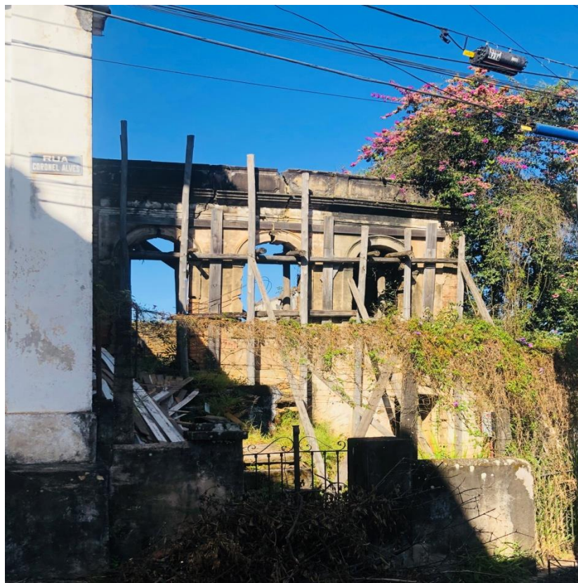
Figura 08: Fachada de casa abandonada no centro histórico de Ouro Preto/MG
