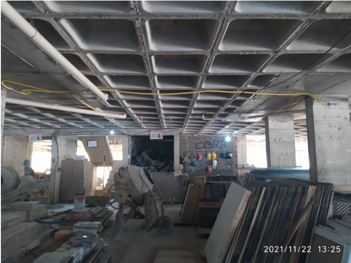
Foto 1 - Equipamentos e materiais, nos pilotis da obra na Construtora H. Ao fundo, o local separado para entrega de EPIs.
