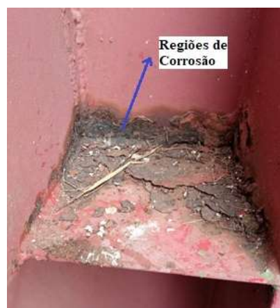
Figura 32: Inspeção visual da: coluna “ \Delta ”, cordão de solda H_2 . Fonte: Pesquisa direta, (2021).
