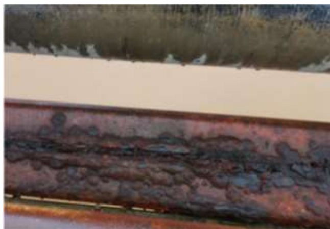
Figura 33: Exemplo de corrosão por frestas. Fonte: Filho et al, (2018)
