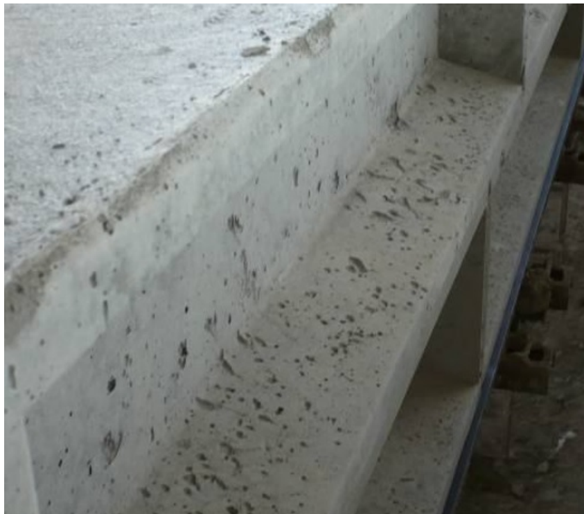
Figura 1 – Estrutura de concreto pré-fabricada apresentando bolhas diversas.
