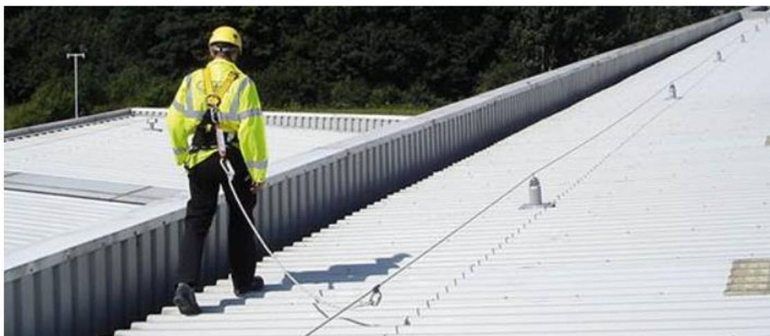
Figura 1: Linha de Vida Horizontal Fonte: Thommem Engenharia (2021)
