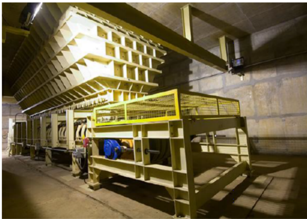
Figura 9 – Alimentador de Correia da Usina de Conceição II.
