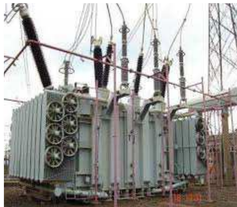
Figura 11 - Transformador regulador na Usina de Itaipu Fonte: (VELÁZQUEZ; MORA; ALVES, 2009, p. 2)
