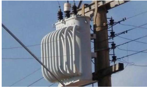
Figura 12 - Transformador em poste Fonte:(BRASIL, 2017)
