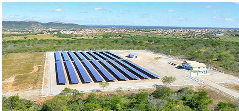
Figura 10 - Usina solar de Tauá Fonte:(SOLAR, 2020)
