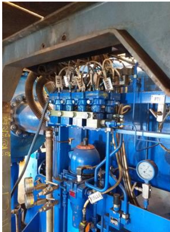
Figura 14 - Válvulas HV Fonte: Weir (2006).
