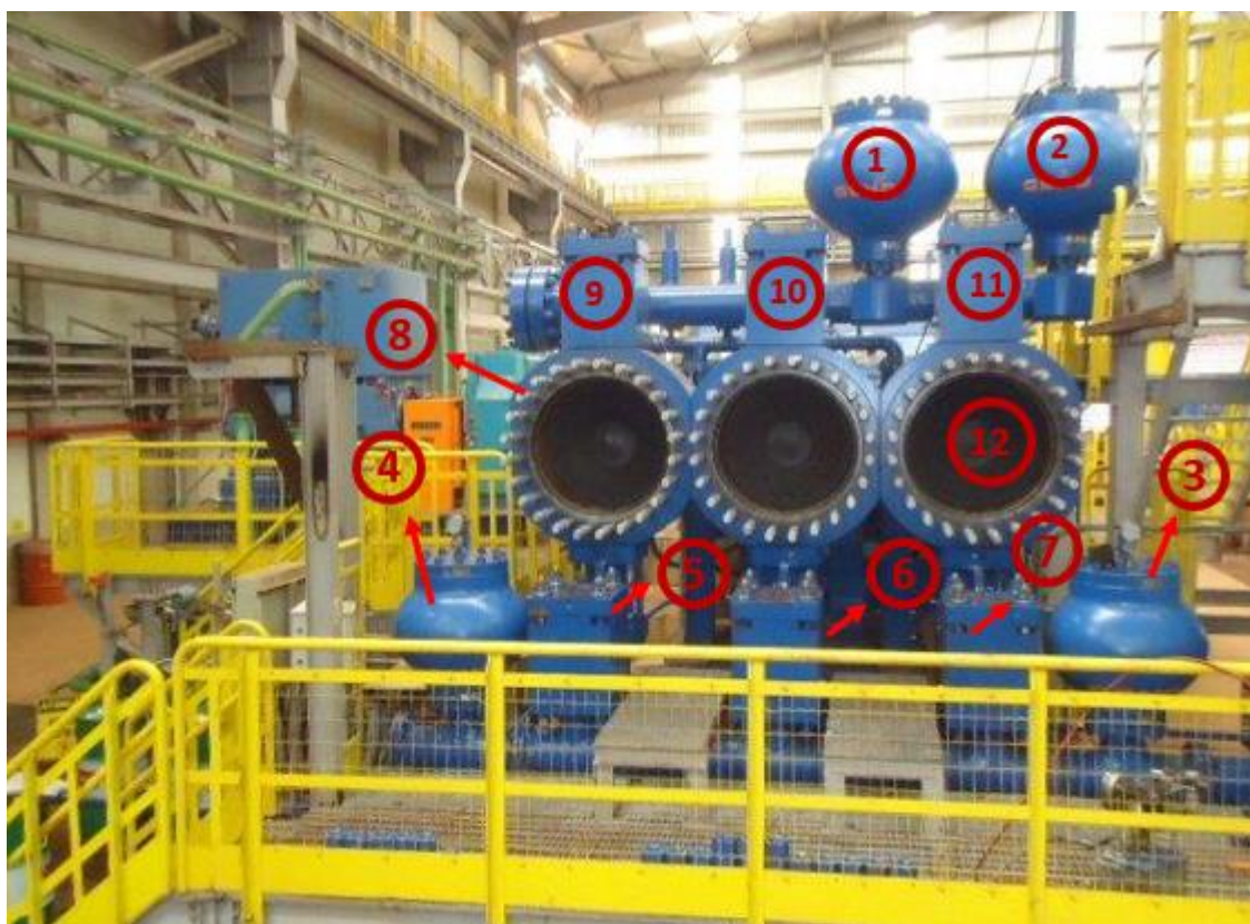
Figura 21 – Bomba Geho TZPM 2000 na estação de bombas 4. Fonte: Pesquisa direta (2020).
