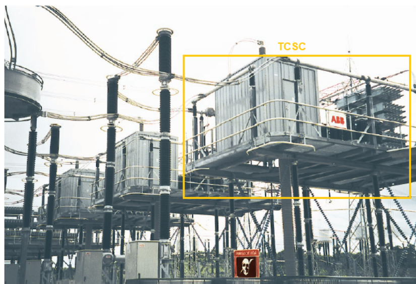
Figura 2 – Módulo TCSC instalado em Imperatriz, MA.
