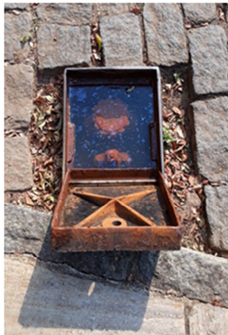
(b) Hidrante com tampa aberta.
