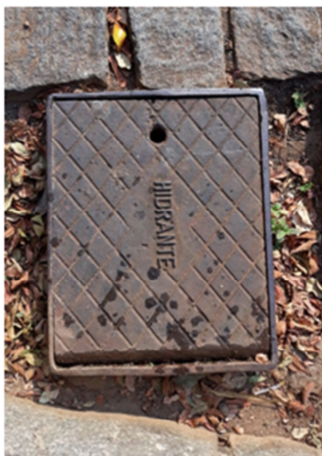
(a) Hidrante com tampa fechada.
