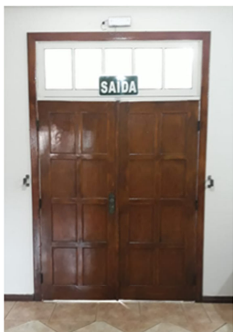
(a) Placa de saída de emergência encontrada no seminário.
