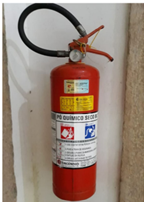
(a) Aparelho extintor de pó químico encontrado na igreja.
