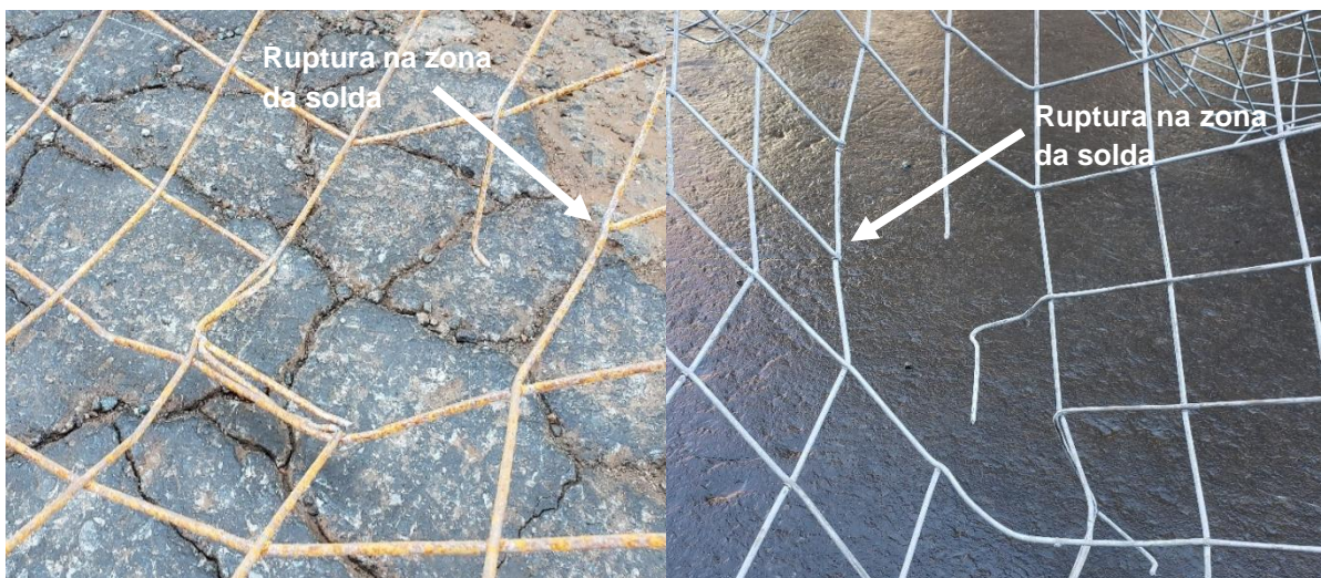
Figura 32 - Ruptura da tela eletro fundida não galvanizada e eletro fundida galvanizada na zona das soldas
