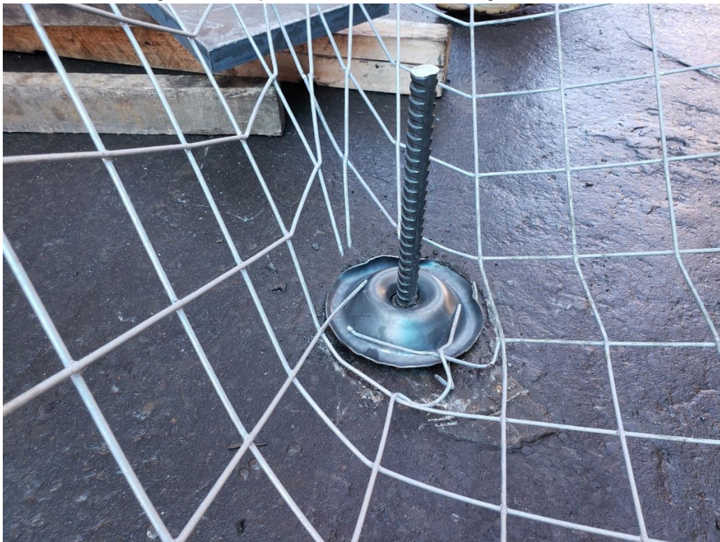
Figura 34 - Ruptura da tela eletro fundida galvanizada
