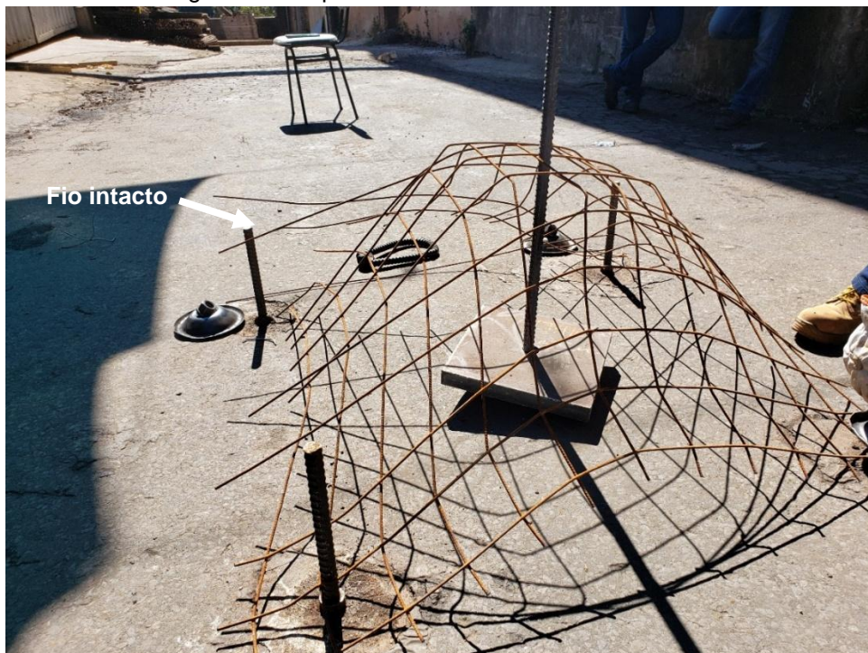
Figura 37 - Ruptura da solda no contato tela/tirante
