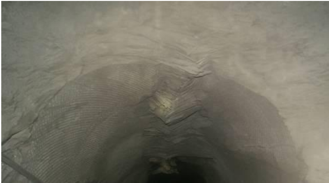
Figura 2 - Ocorrência de buckling em uma escavação
