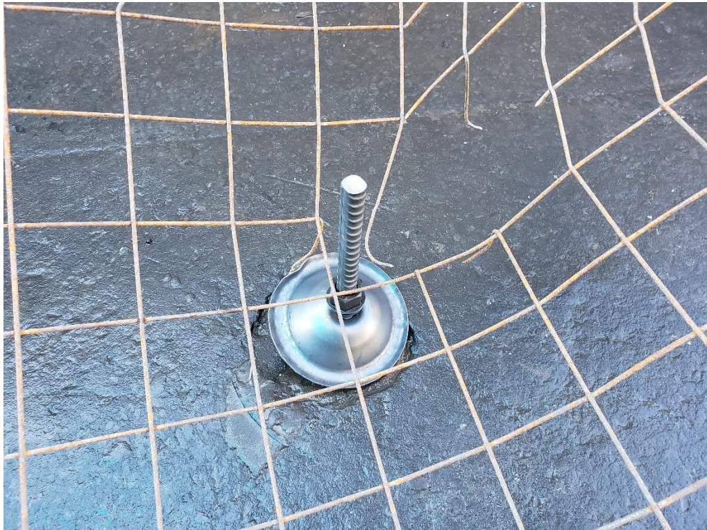
Figura 33 - Ruptura da tela eletro fundida não galvanizada
